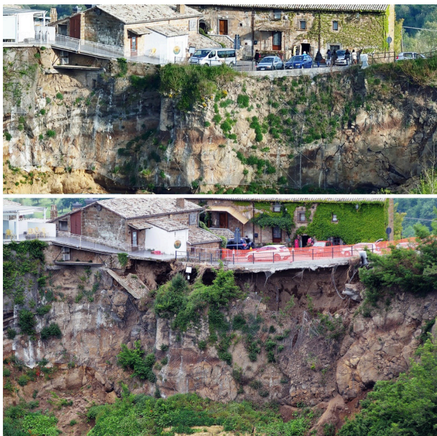
Figura 4 Scarpata sul lato nord della località Mercatello (strada di accesso al ponte per Civita) in crollo progressivo dal mese di aprile 2015, con evidenti problemi di sicurezza per il fabbricato in sinistra nella foto.
