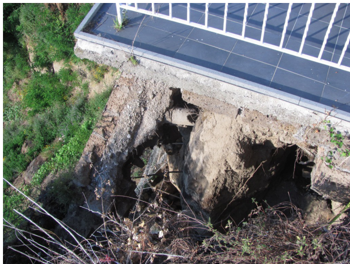
Figura 6 Scarpata sul lato nord della località Mercatello in crollo - particolare del tufo crollato al di sotto dello spigolo nord-orientale del fabbricato.
