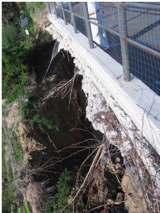
Figura 5 Scarpata sul lato nord della località Mercatello in crollo - particolare della soletta in calcestruzzo armato, che si trova sospesa per diversi metri sopra il tufo crollato, per una profondità orizzontale fino a 3,5 metri.
